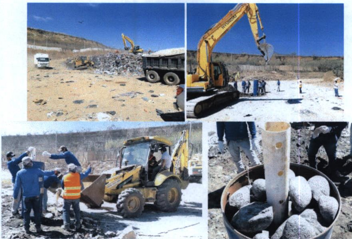
Fotos 35-42: Impactos negativos que se observan por no contar al 100% con la maquinaria para operar los residuos que ingresan al vertedero. Así mismo la descarga de camiones en el frente operativo.
